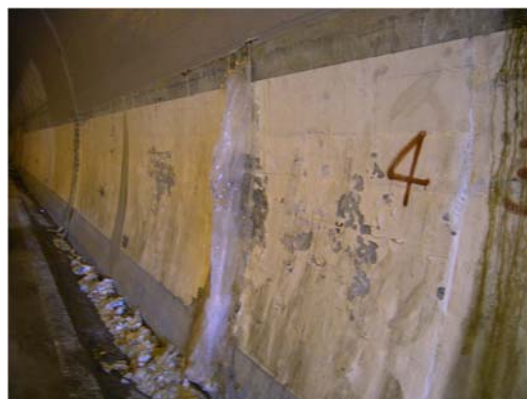
写真-1 トンネルにおける冬期の漏水氷結
