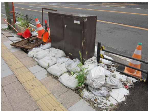
沈下した変圧器塔
