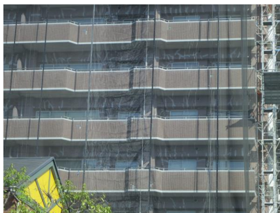
窓際の梁の修理跡
