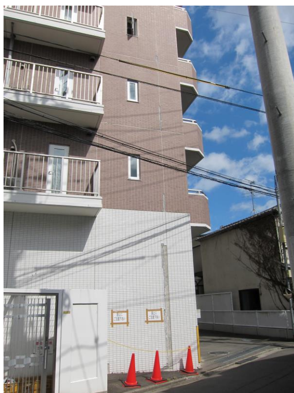
タイルの剥離（南側）
