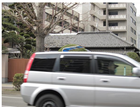
棟瓦が崩落した住宅
