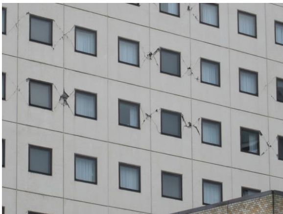
窓間のせん断破壊
