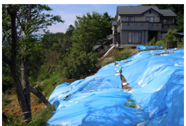
地震被害を受けた住宅
