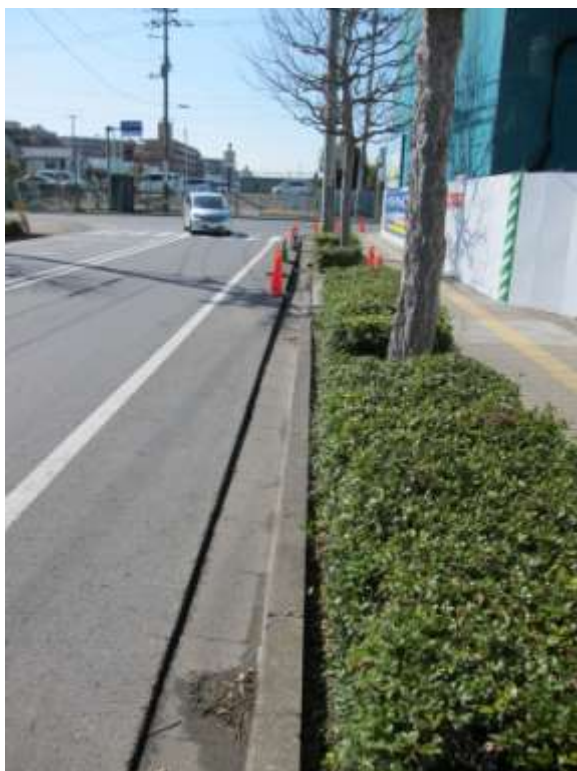
車道端に生じた舗装と側溝の段差
