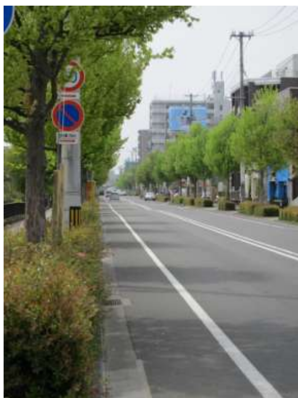
車道に生じた凹凸
