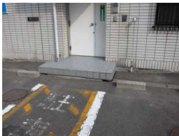
入り口と舗装の間に生じた隙間
