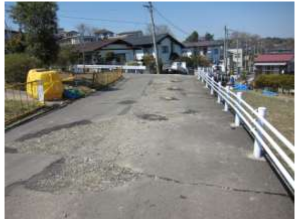
ひび割れてはがれた舗装路面
