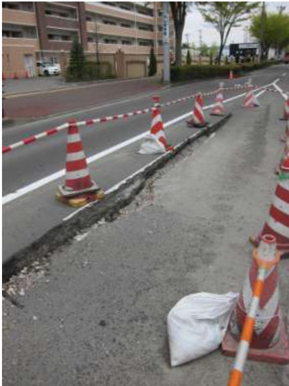
道路上の段差（手前側が陥没）
