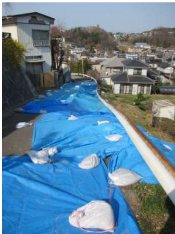
ひび割れで通行不能になった坂道
