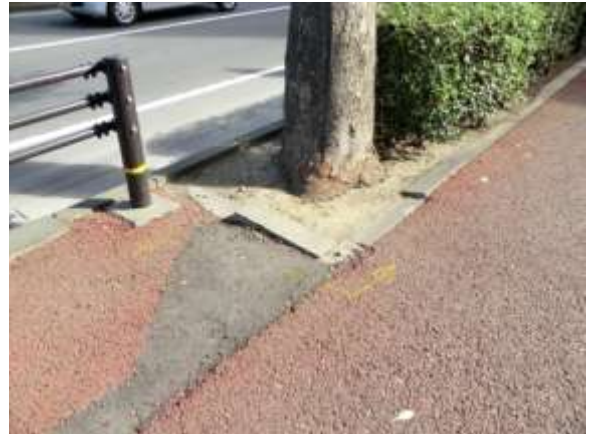
街路の縁石の上下のずれ
