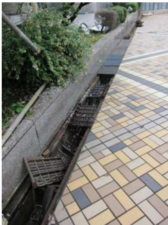
押されて割れた側溝の鉄製の蓋
