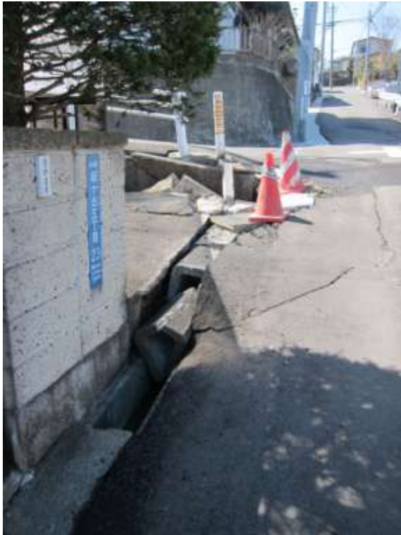
押されて割れたコンクリート製の側溝 の蓋と盛り上がった舗装
