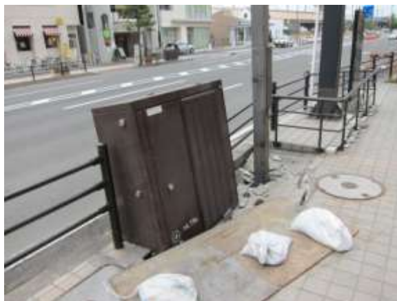
道路占用物（変圧器塔）を別方向から
