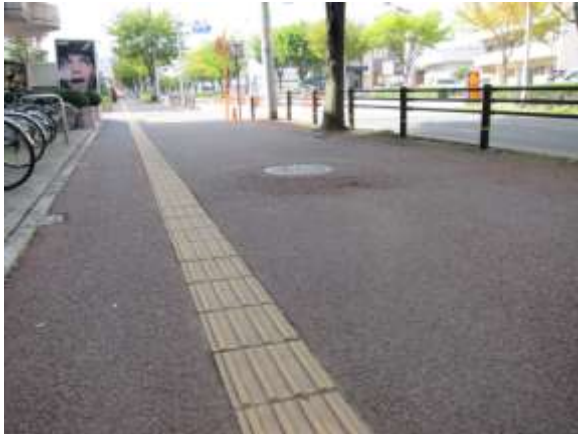
液状化による歩道上のマンホールの浮き上がり
