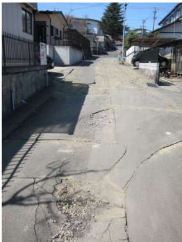
ひび割れてはがれた舗装路面
