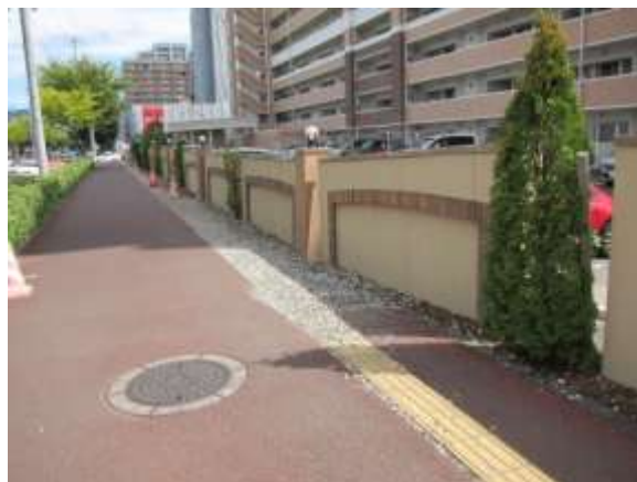
液状化に伴う塀の沈下（左の写真の反対側）
