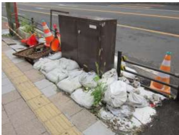
沈下した道路占用物
