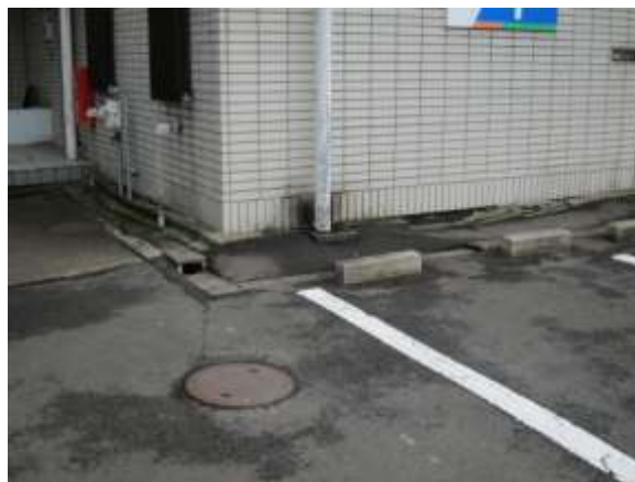
駐車場の舗装の陥没 2
