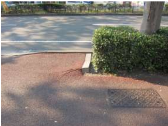
街路樹周りの縁石の傾き
