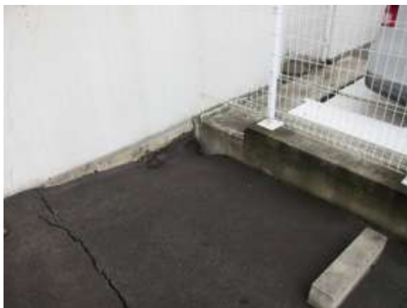
駐車場の舗装の陥没 1
