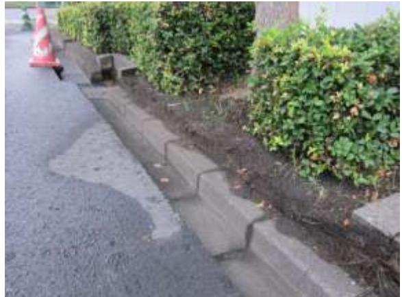
側溝の沈下で土がむき出し（歩道側だが 関連の車道の場所に掲載）
