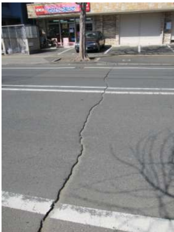
車道全体に生じた亀裂
