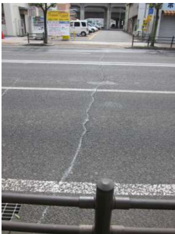
排水性舗装上の新たな横ひび割れ
