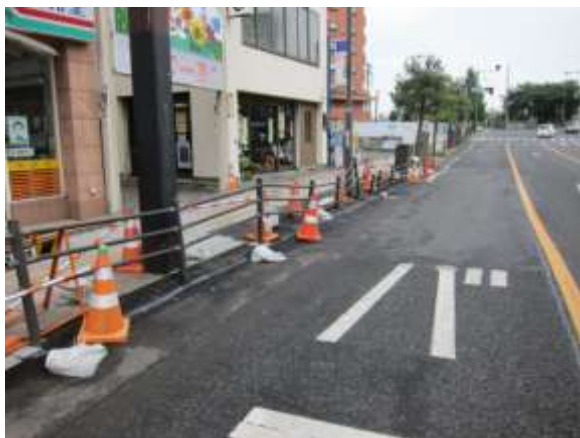
地盤沈下で傾いた柵（長町1丁目）
