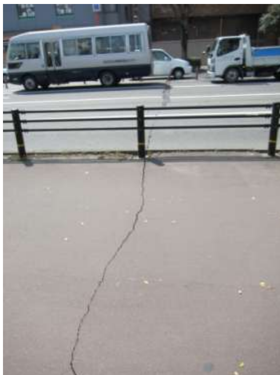
道路全体に生じた亀裂
