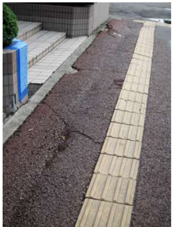
歩道に生じたくぼみとひび割れ
