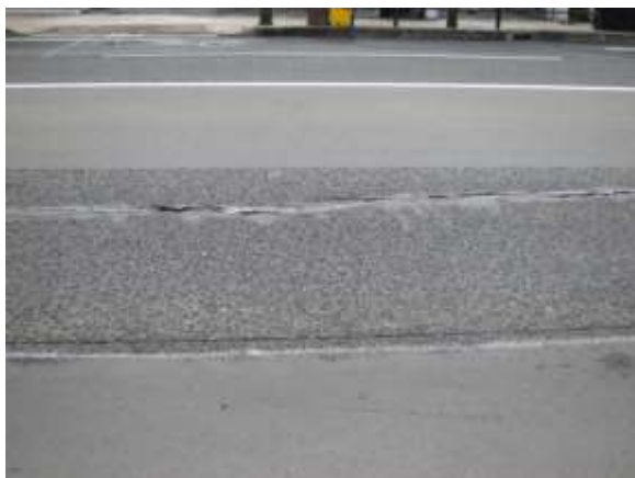
排水性舗装上の新たな縦ひび割れ
