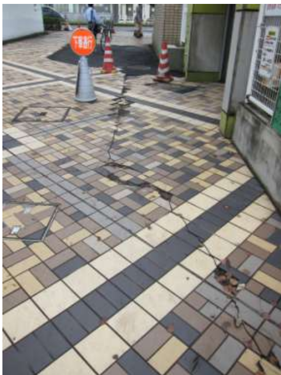
平板のひび割れ
