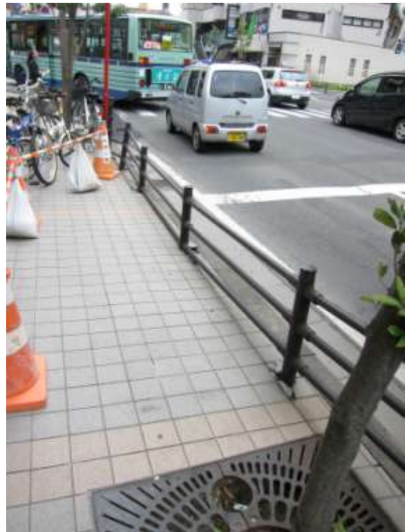
歩道の柵の足も沈下（この下は空洞？）
