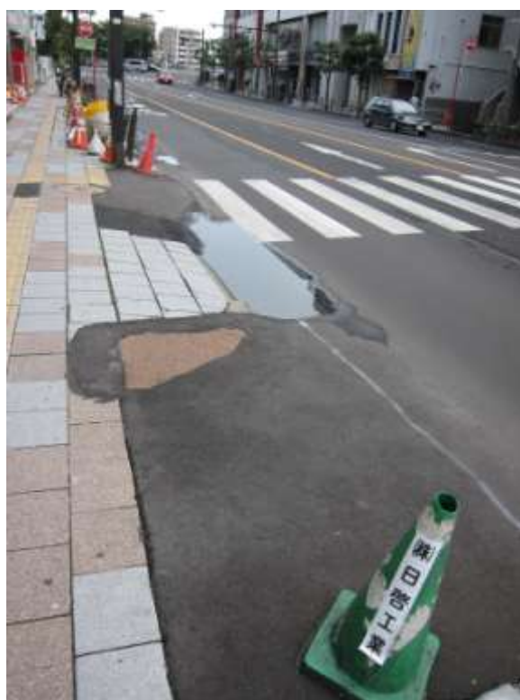
側溝が埋められた道路
