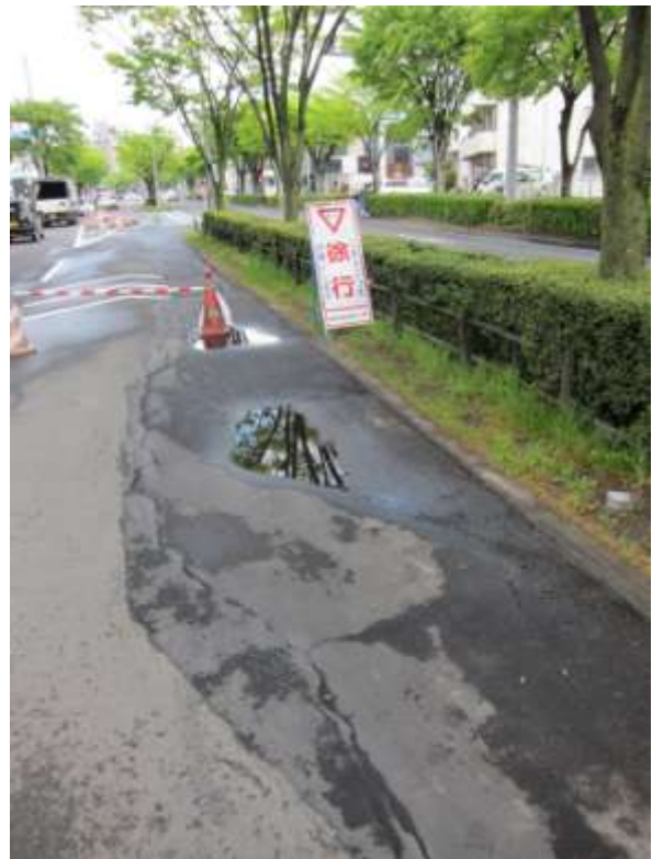
中央部が沈下して出来た水たまり
