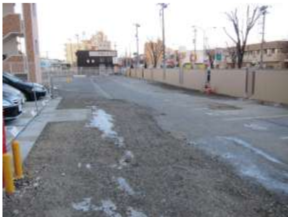
液状化に伴う駐車場の沈下
