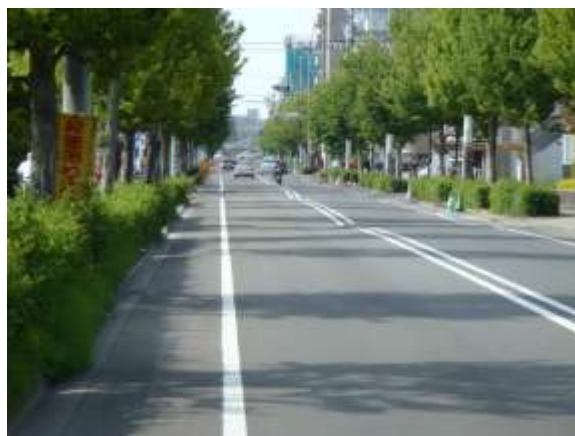
車道に生じた凹凸（拡大）
