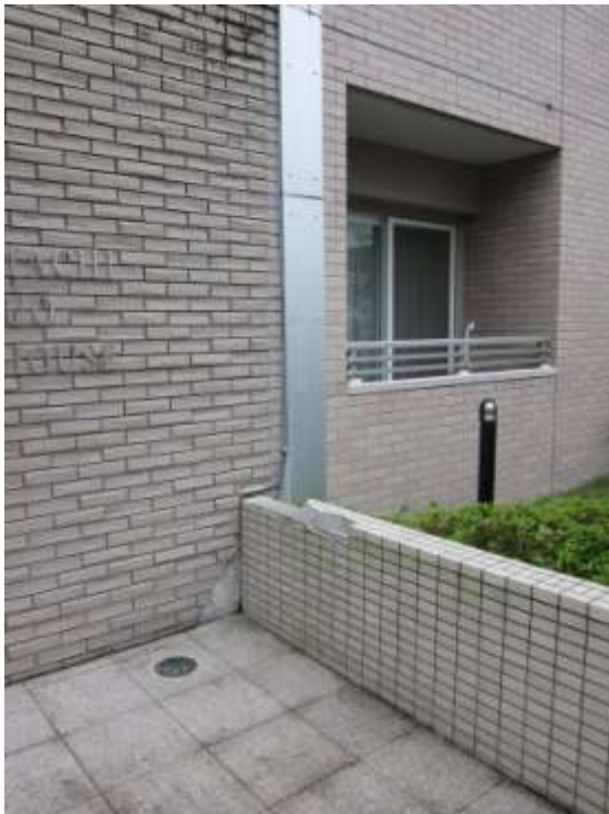
タイルの剥がれと欠け（未修復）
