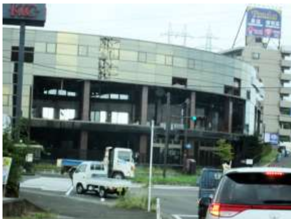
ガラス外壁の破損 1
