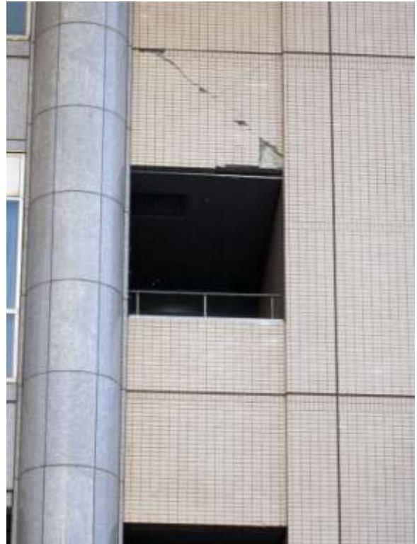
開口部付近のタイルの剥離と斜めひび割れ（3，4階部分）
