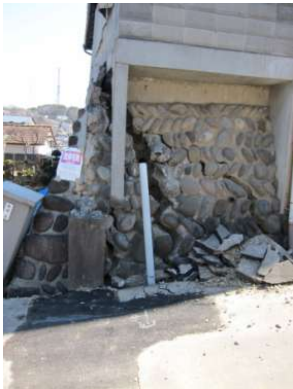
ひび割れた石垣
