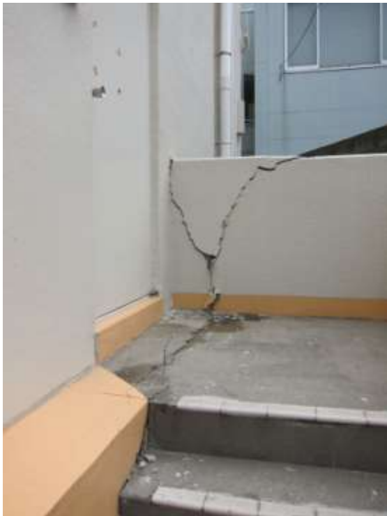
マンション裏口付近のひび割れ
