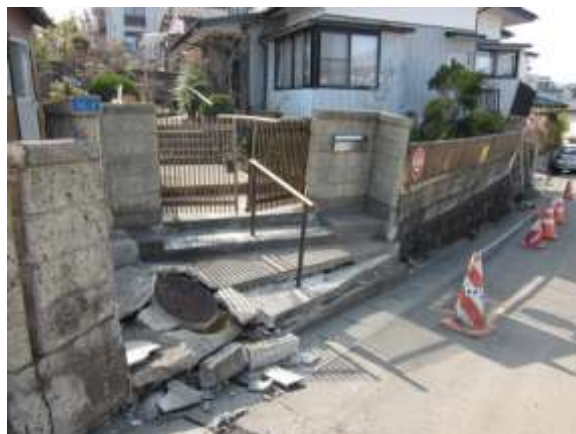
地盤の側方移動ではらみだした塀
