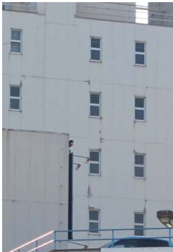
建材目地方向のひび割れと欠け
