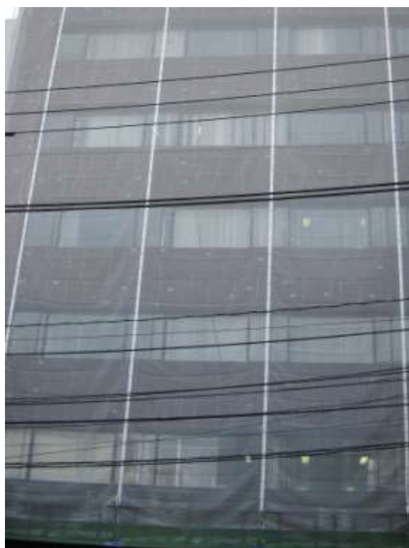
損傷箇所を確認後
