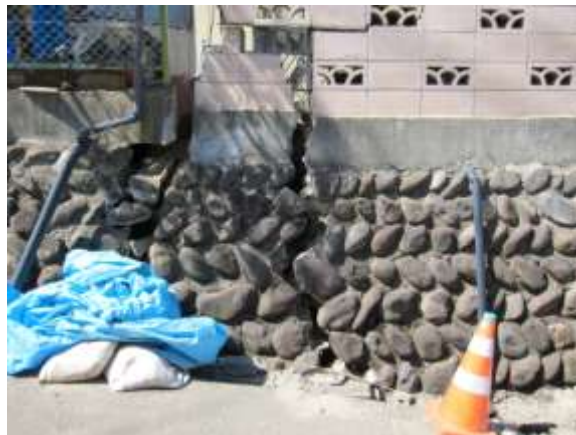
裂けた石垣とブロック塀
