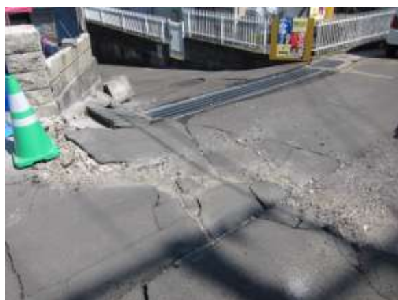
門柱とブロック塀の脱落
