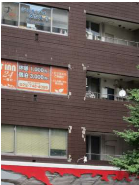
窓際の隅のタイルの剥離が目立つ
