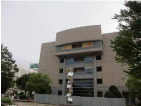
ビル被害（最終撮影時点未修復） 太白区役所
