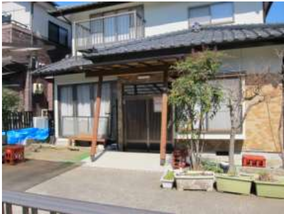
斜めになった玄関の柱
