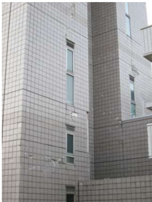
タイルの剥離とひび割れ（西側）
