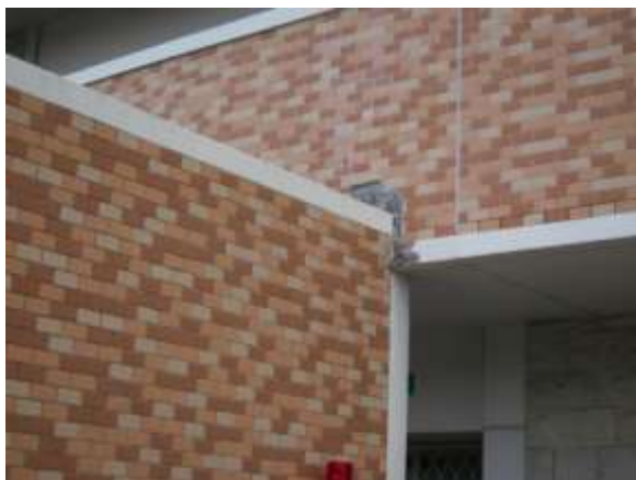
構造隅角部のタイルの剥がれ
