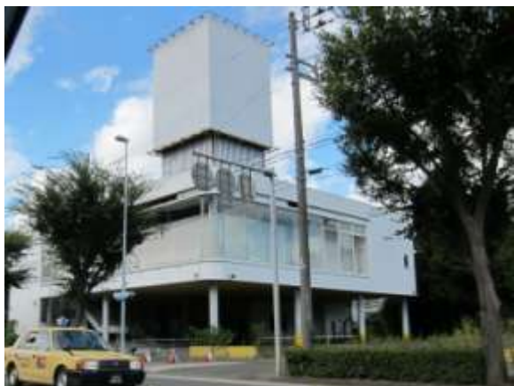
ガラス外壁の破損 2
