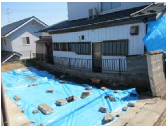
石垣の側方移動と地割れで変形した住宅と宅地
