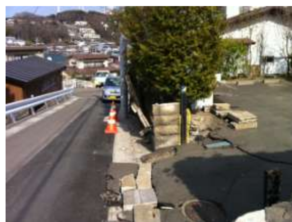
ブロック塀の転倒（三浦上総君撮影）
