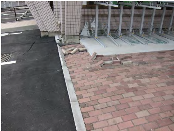
飛び出したブロック
