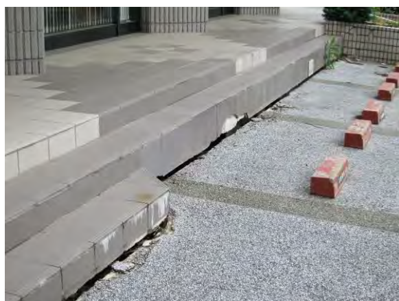
駐車場と建物との間に生じた隙間
