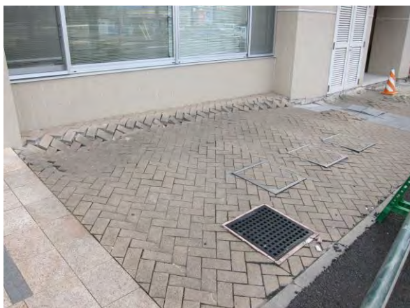
接続部の地盤が沈下
