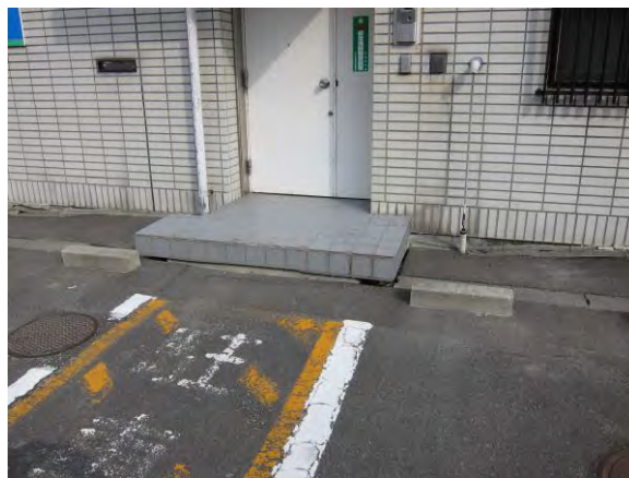
入り口と舗装の間に生じた隙間
