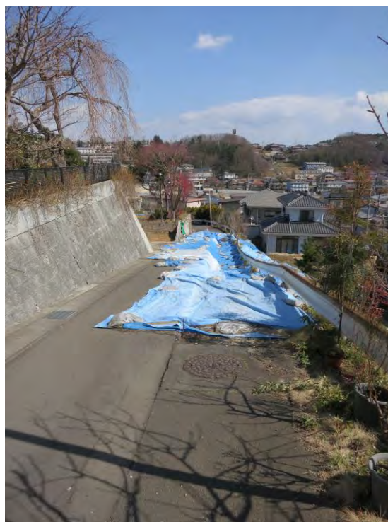
相変わらず通行止め
