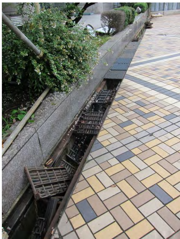
押されて割れた側溝の鉄製の蓋
