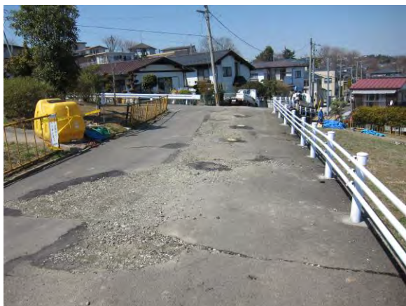
ひび割れてはがれた舗装路面 前ページ公園脇の道路
