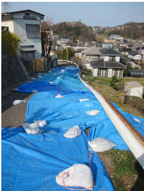
ひび割れで通行不能になった坂道
