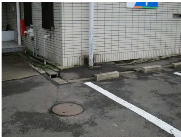
駐車場の舗装の陥没 1
