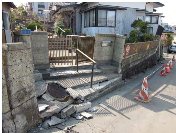
地盤の側方移動ではらみだした塀
