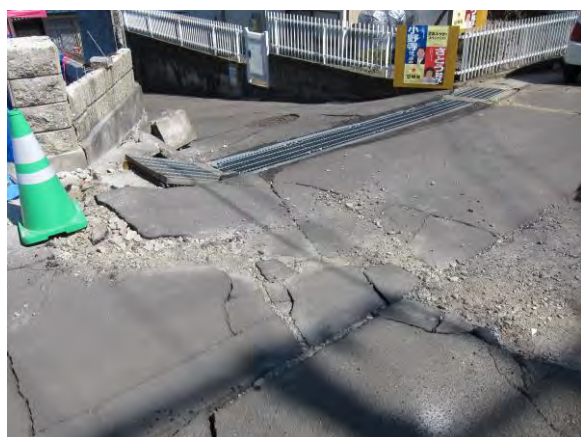
門柱とブロック塀の脱落
