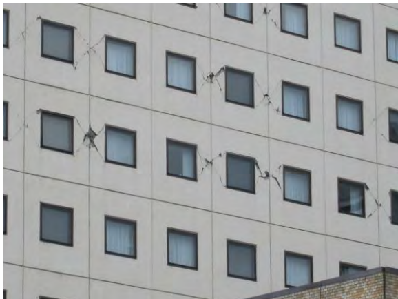
窓間の外壁のせん断破壊
