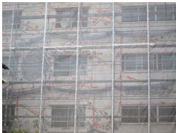
ネット越しに見える多数の損傷箇所
