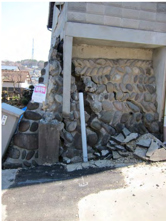
ひび割れた石垣
