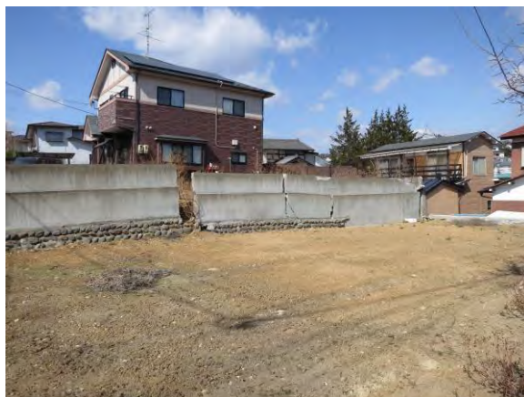
擁壁が割れて波打っている
