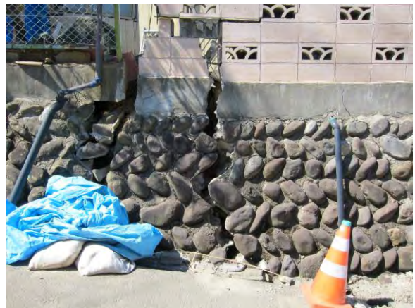
裂けた石垣とブロック塀
