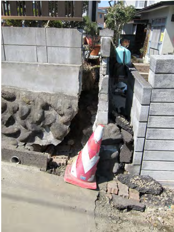
地盤の側方移動ではがれた石垣とブロック塀
