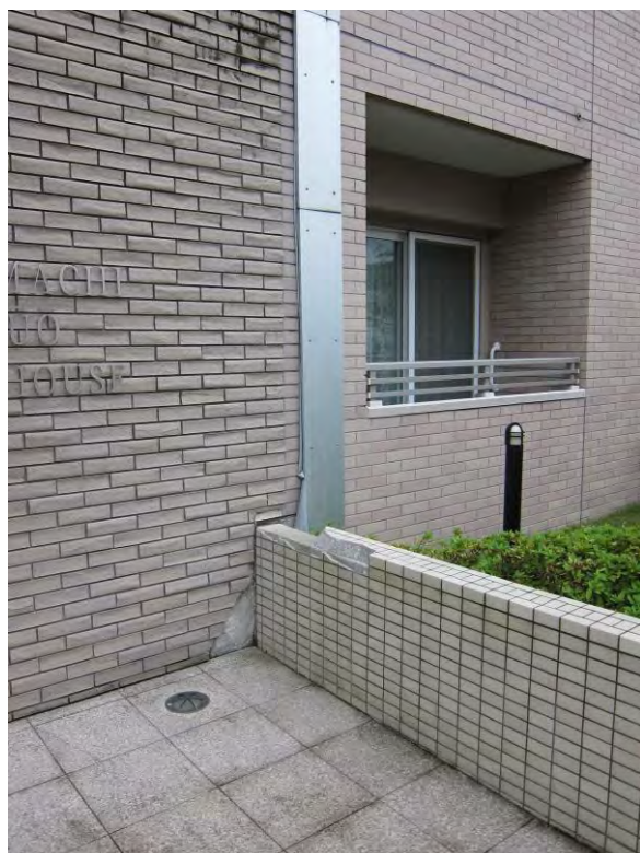
タイルの剥がれと欠け
