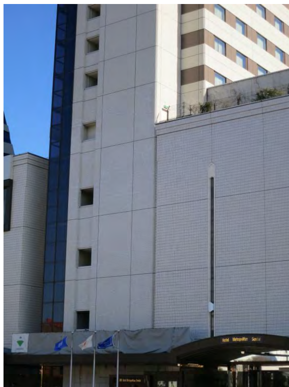
構造が変わる階前後の壁に修理跡
