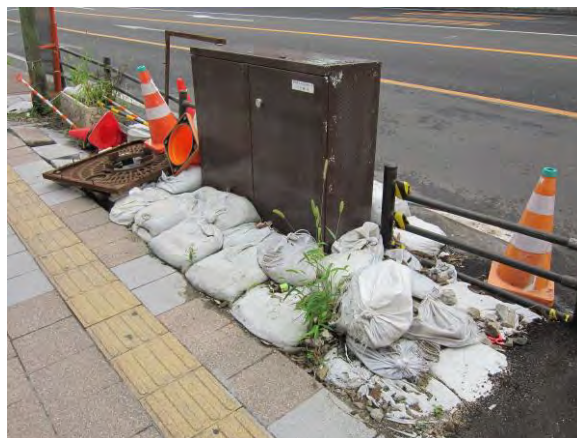
沈下した道路占用物
