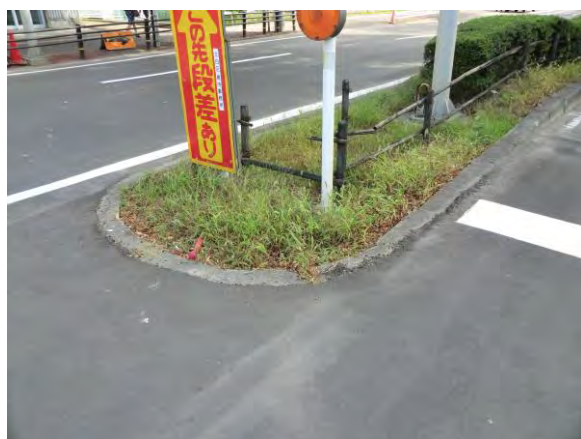
沈下した中央分離帯
