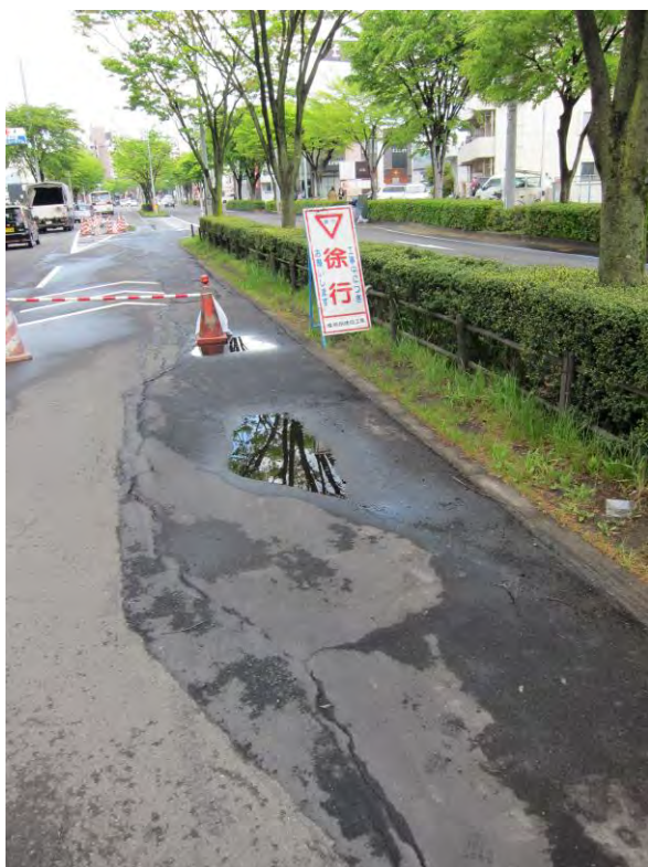
中央部が沈下して出来た水たまり
