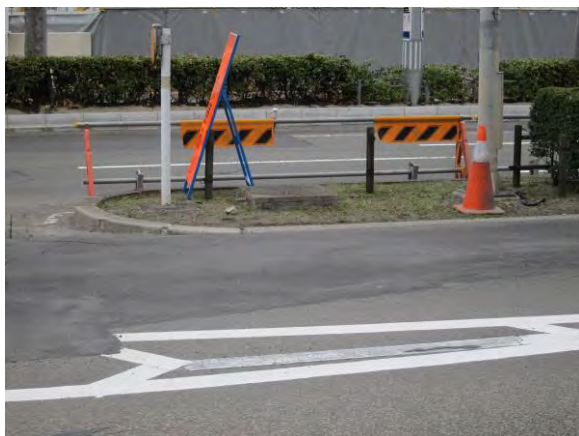
浮き上がった路上施設
