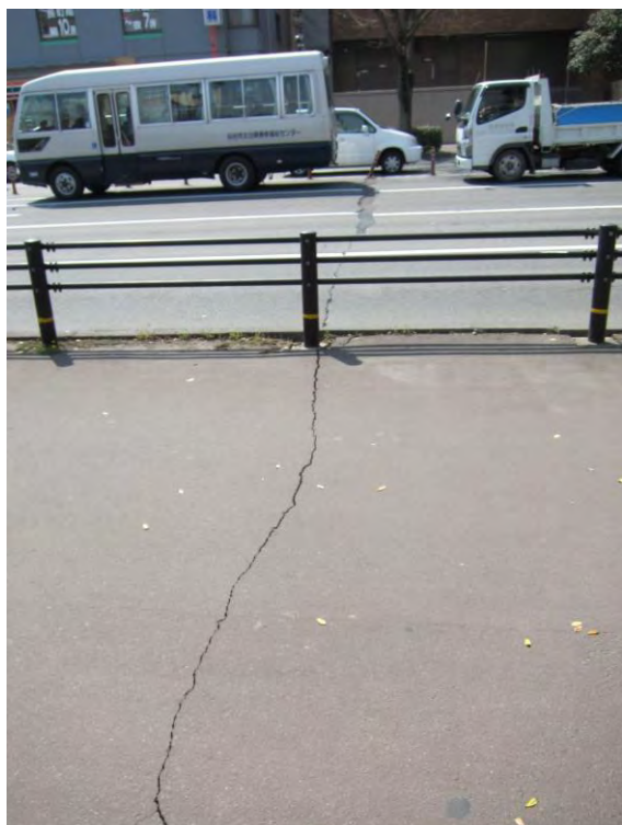
道路全体に生じた亀裂
