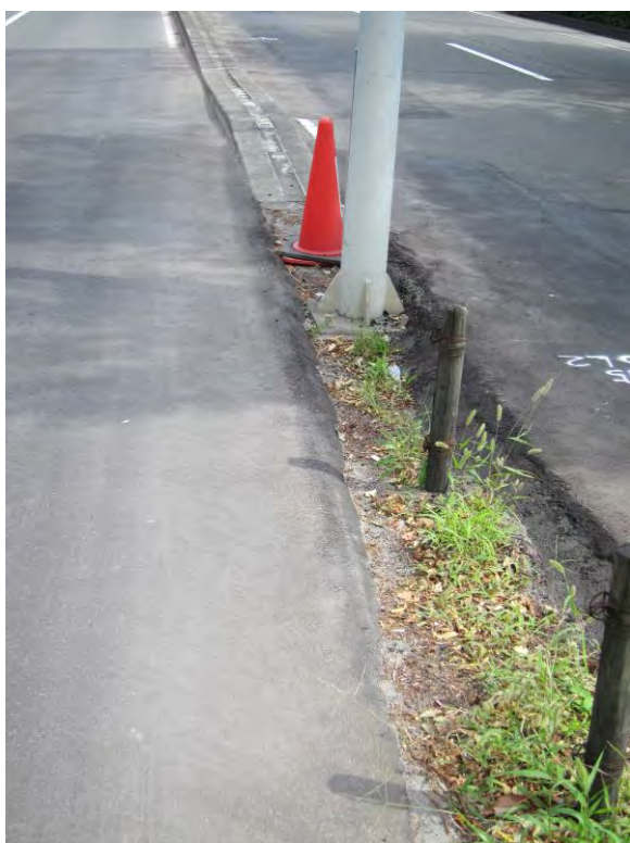
一部は車道より低くなった
