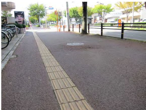
歩道上のマンホールの浮き上がり
