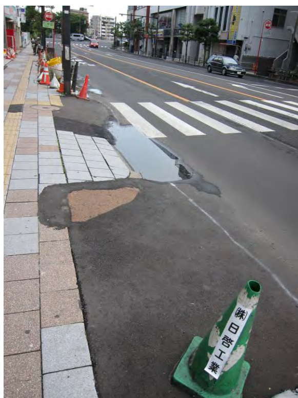
側溝が埋められた道路
