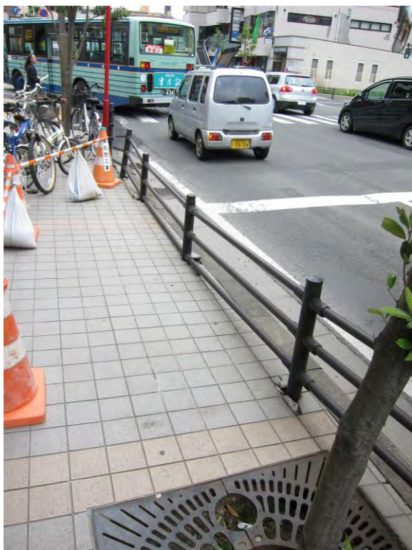
歩道の柵の足も沈下（この下は空洞？）
