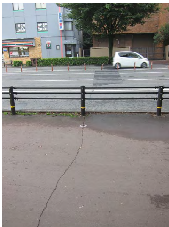
余震で車道の亀裂が拡大し補修を繰り返している
