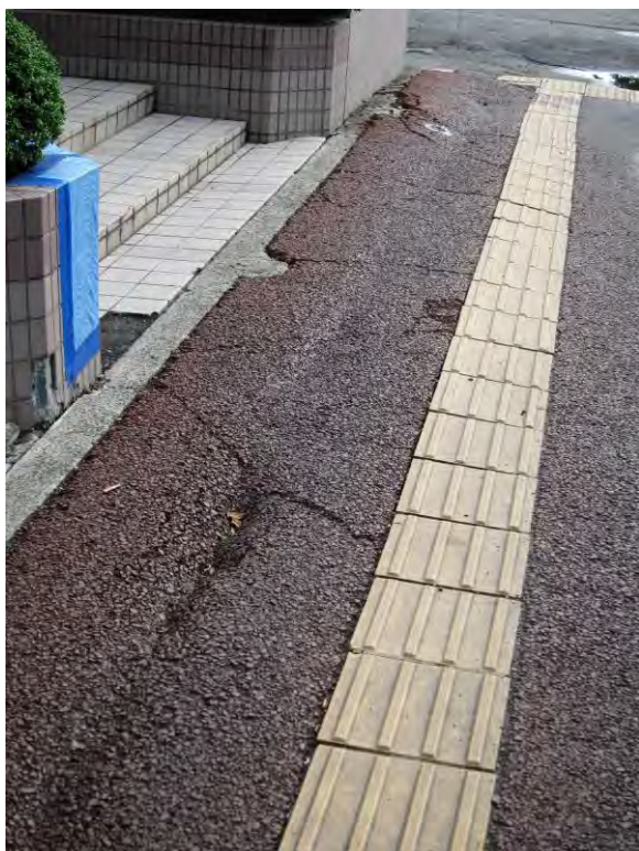
歩道に生じたくぼみとひび割れ
