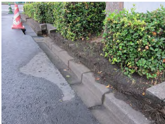
縁石の沈下で植栽の土がむき出しに
