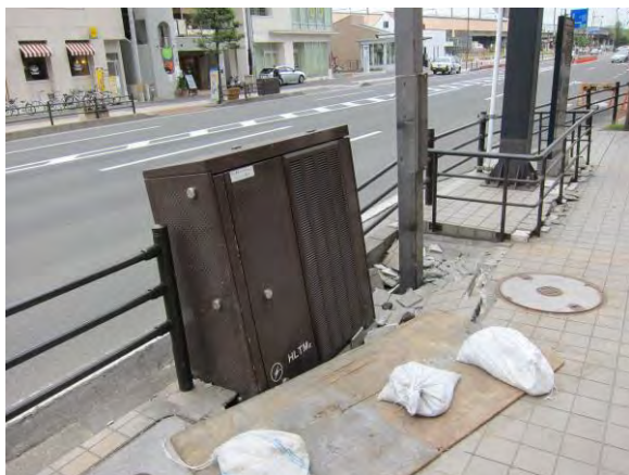
道路占用物（変圧器塔）
