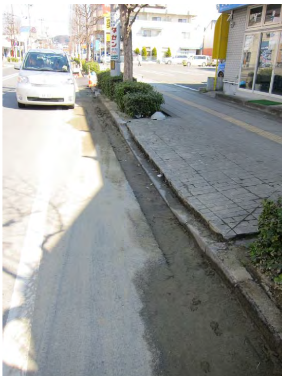
側溝にたまった噴砂と歩道の段差
