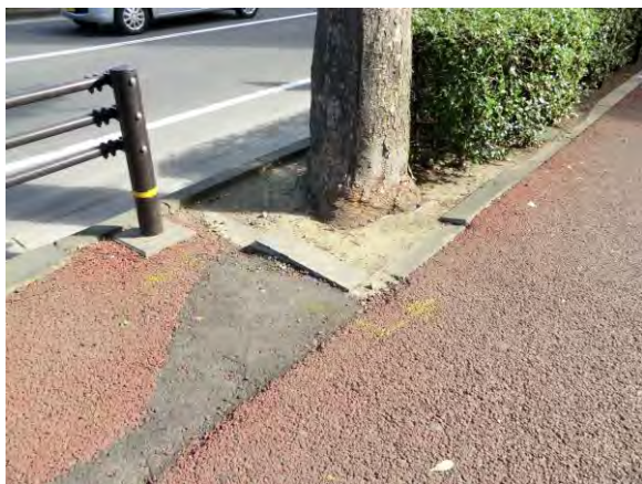
街路の縁石の傾き
