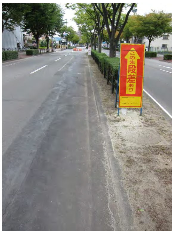
中央分離帯は沈下
