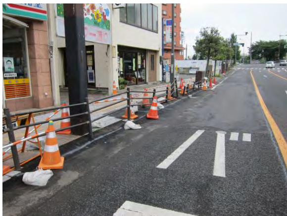
地盤沈下で傾いた柵（長町1丁目）
