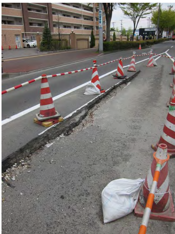
生じた段差（手前側が陥没）
