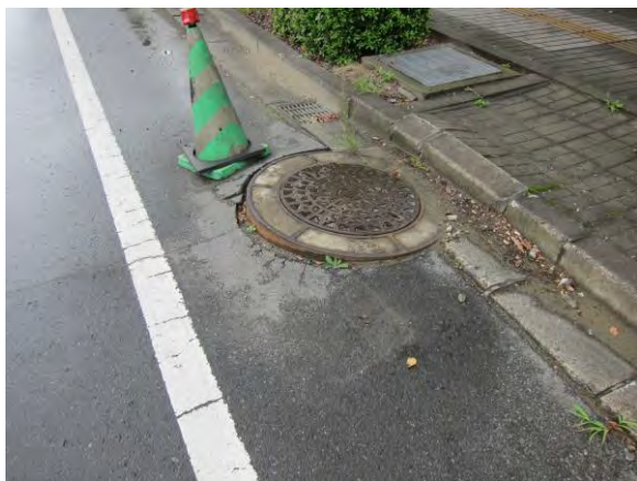
マンホールの浮き上がり
