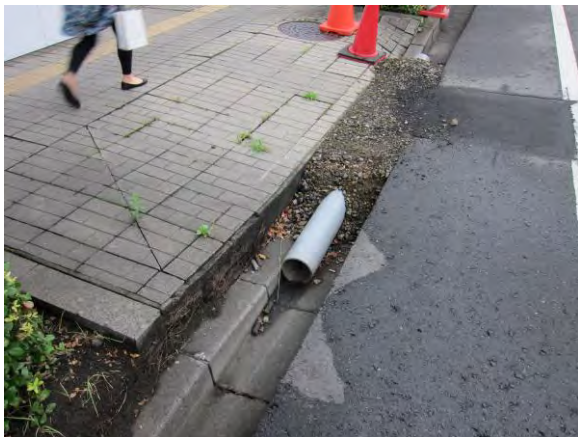
駐車場出入口口 側溝に水を流す為の工夫
